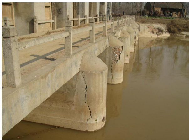
王庄闸下游闸墩裂缝
