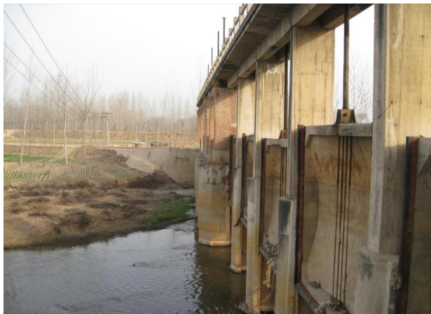
罗寨闸闸门铁件锈蚀
